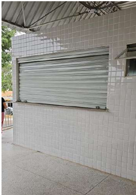
Figura 4 - Espaço previsto para instalação de lanchonete e que funciona para armazenamento produtos de limpeza.
