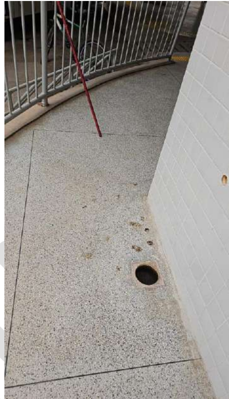
Figura 27 - Ralo sem Tampa, risco de acidente.
